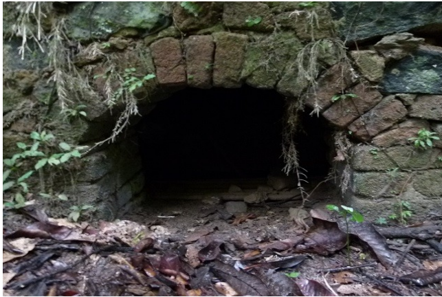
Illustration 1: Vue extérieure d'un des deux fours
